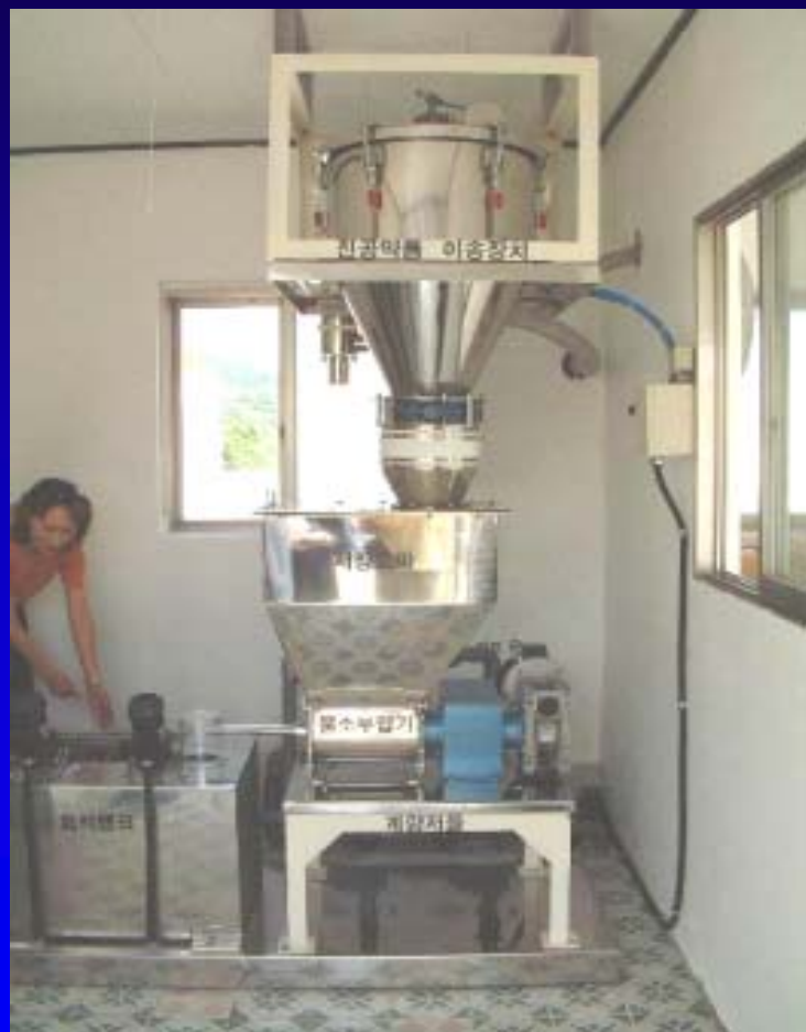
(韓国 陝川邑浄水場フッ素添加装置)
