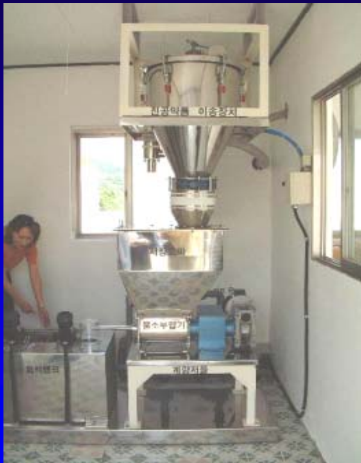
(韓国 陝川邑浄水場フッ素添加装置)
